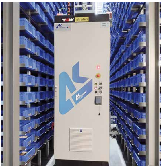
Mitfahrender Schaltschrank des Regalbediengerätes
