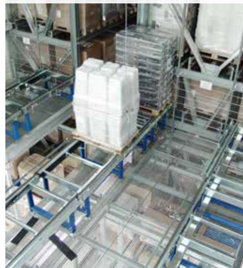
Hochregallager mit 11.600 Palettenstellplätzen
