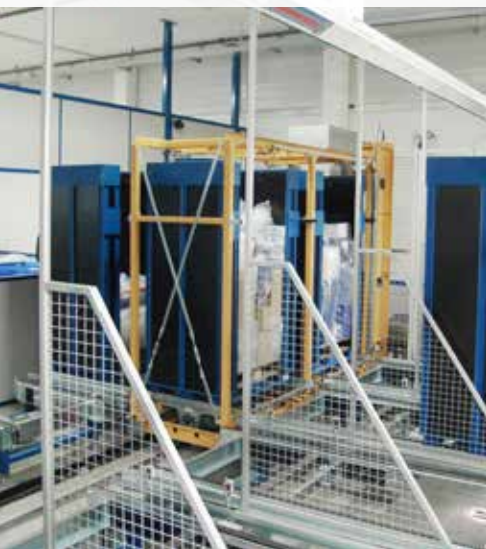
Transferwagen mit Stützrahmen für Auftragspaletten
