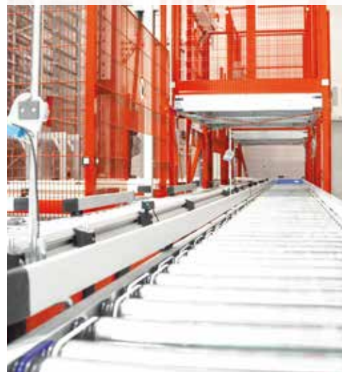
Vorzone des Tiefkühlagers bei -22°C
