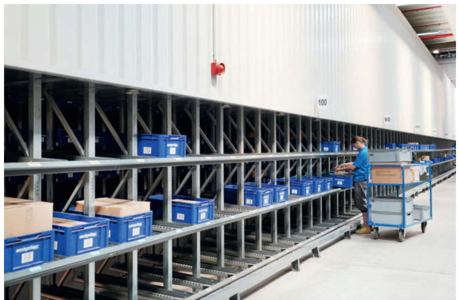
Retrofit des ein-gassigen, automatischen Kleinteilelagers mit seitlichen Durchlaufkanälen.
