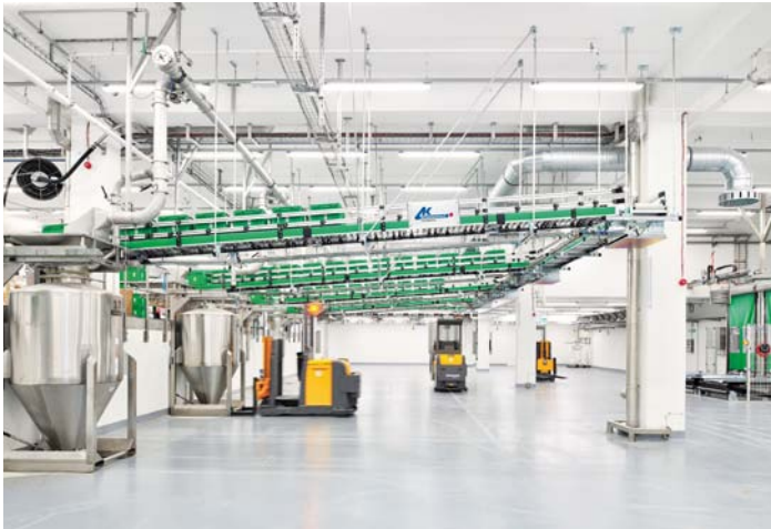
Diverse Stationen: Ziel ist eine durchgehende Prozessoptimierung vom Lager über Mischerei, Kommissionierung bis zum Versand. (Bilder: Klinkhammer)
