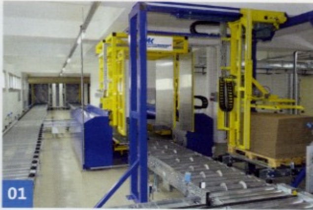
01 Drei verschiedene Produktionsbereiche sind über Förderbrücken angebunden
