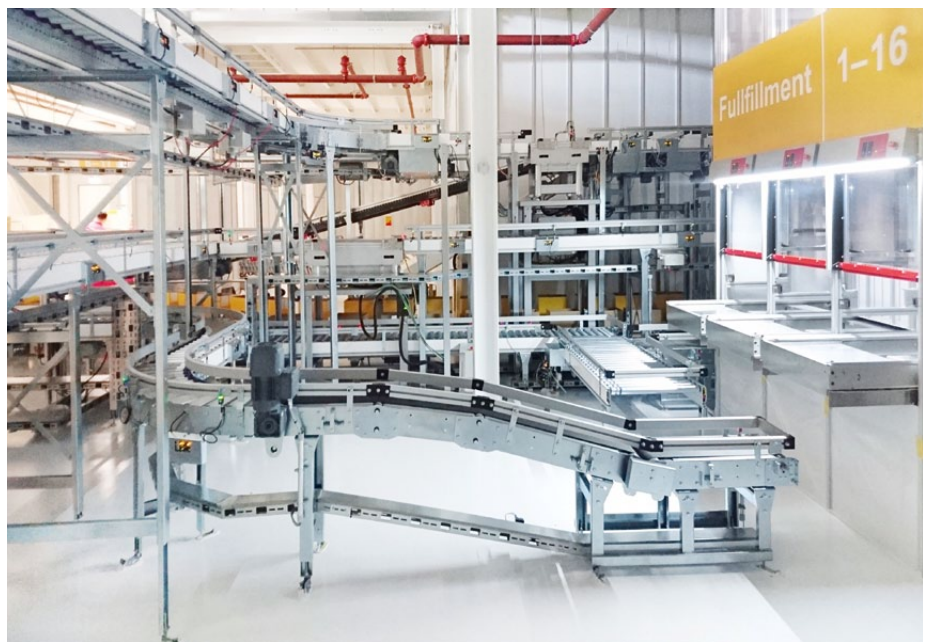
Fördertechnik zur Roboter-Kommissionierzelle
