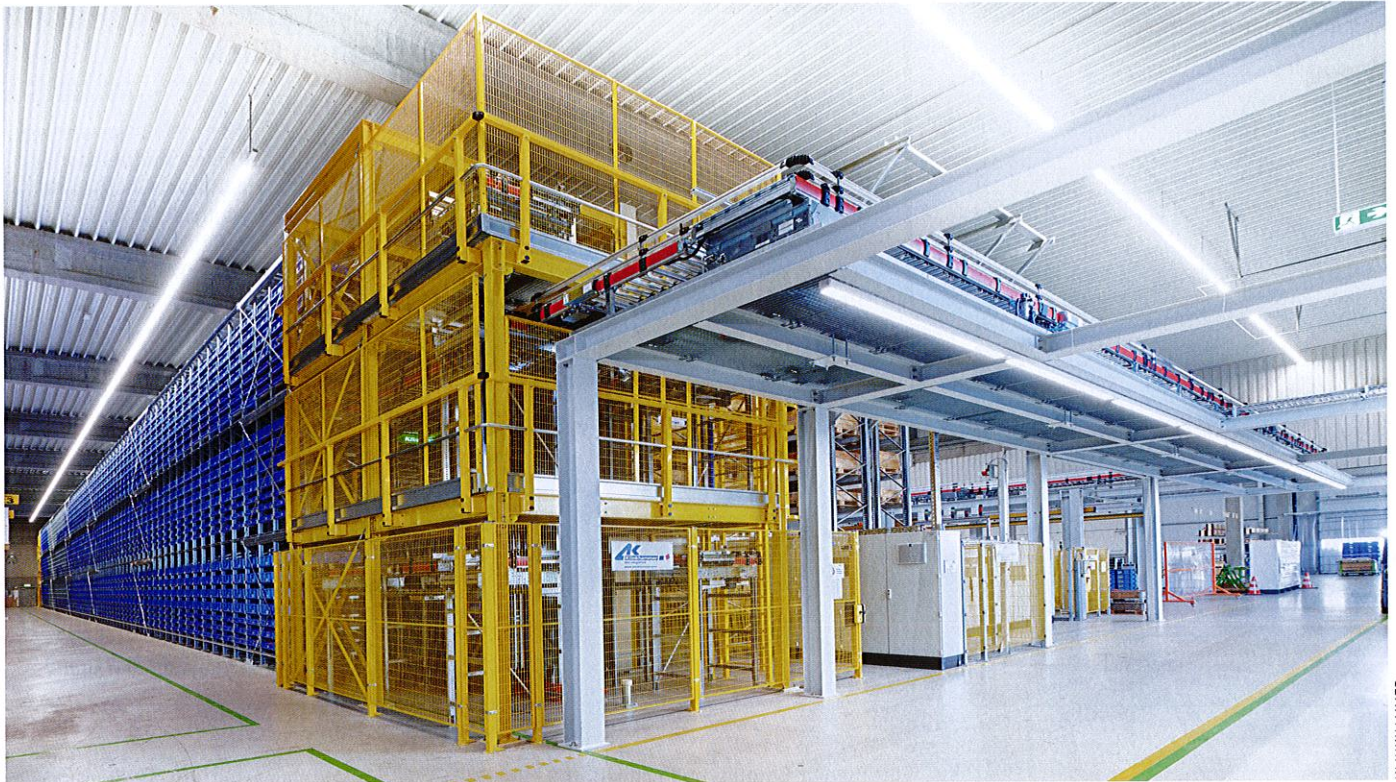
Vorzone des Multi-Level-Shuttles mit Fördertechnikbühne
