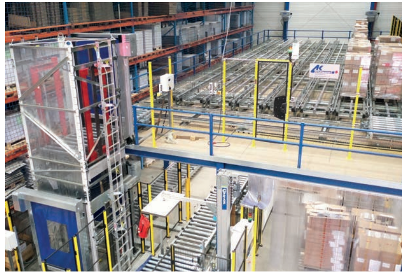
Heber, Palettenwickler und Pufferspeicher auf einer Bühne
