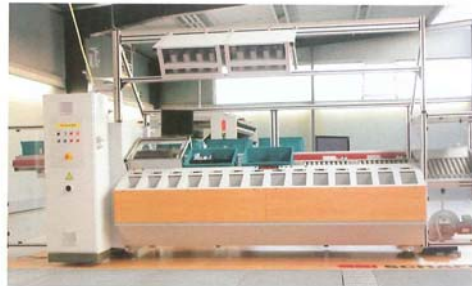
Arbeitsplatz des „pick to bucket“-Kommissioniersystems
