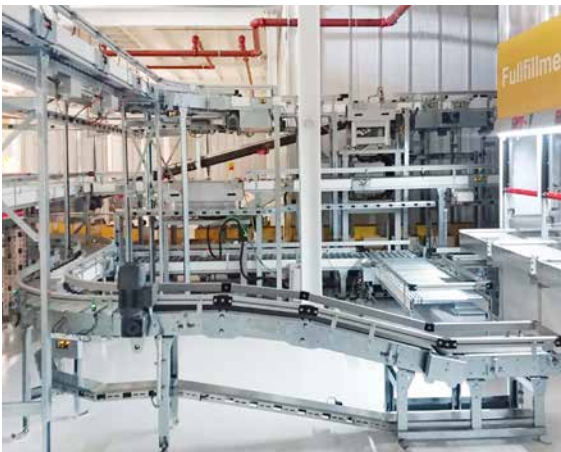
Fördertechnik zur Roboter-Kommissionierzelle
