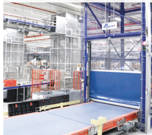
Warenausgang mit Modulband-Gerüstschachtheber
