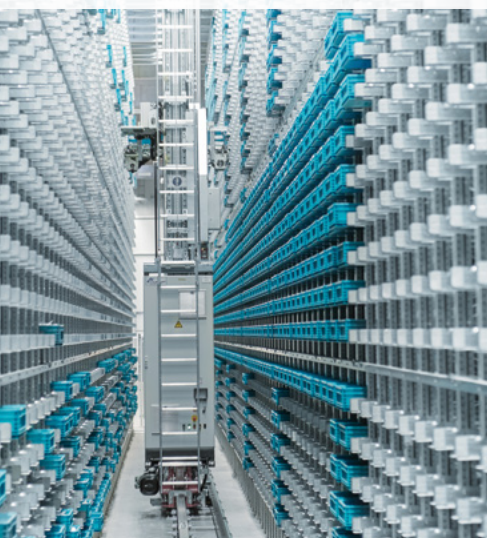
Zweigassiges, automatisches Kleinteilelager mit 17.820 Behälterstellplätzen
