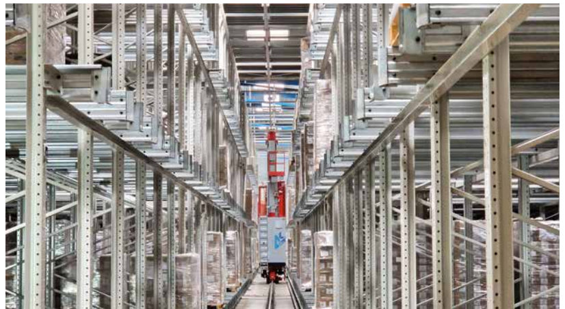
Eingassiges Kanallager für 2.100 Palettenstellplätze
