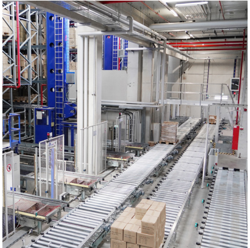
4-gassiges Hochregallager mit Fördertechnik-Vorzone
